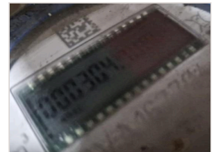
F4 Comptador d'aigua, bateria de l'immoble
